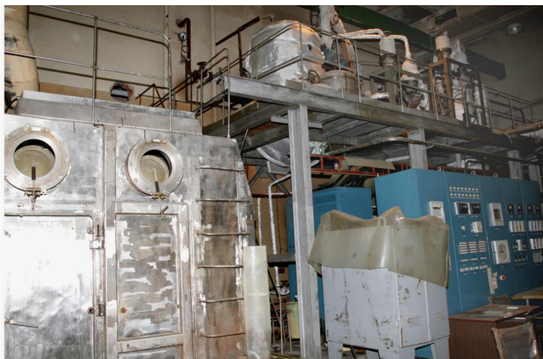
Рисунок 2 – Зд. 500. Стендовый зал №2 (пом. 150). Справа – Выпарной стенд. Слева – Камера фрагментации (разделки) радиоактивных материалов
