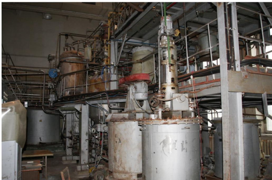
Рисунок 1 – Зд. 500. Стендовый зал №2 (пом. 150). Стенд переработки «солевых» отходов
