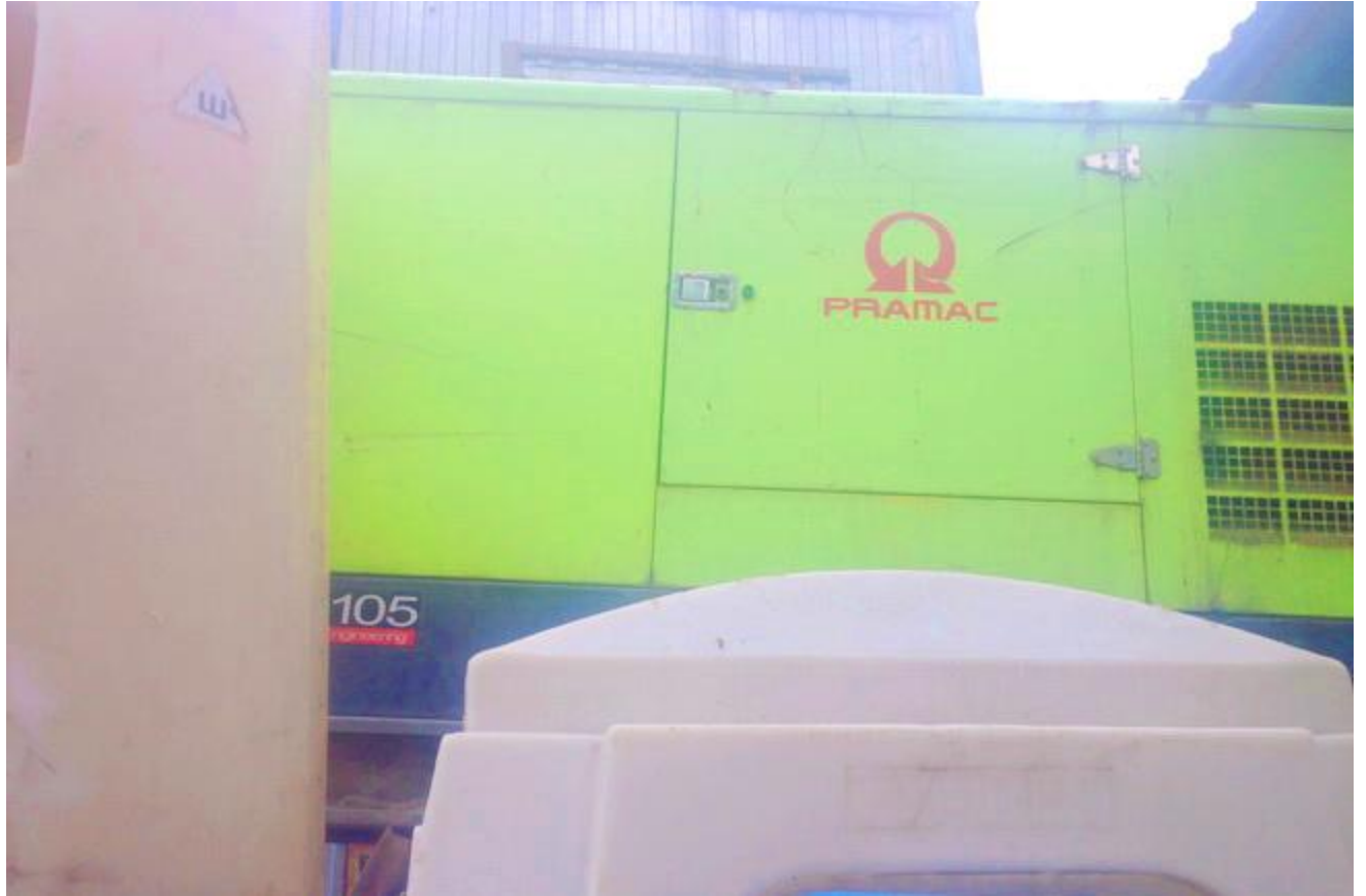
Фото: Общий вид электростанции GSW105DFDS
