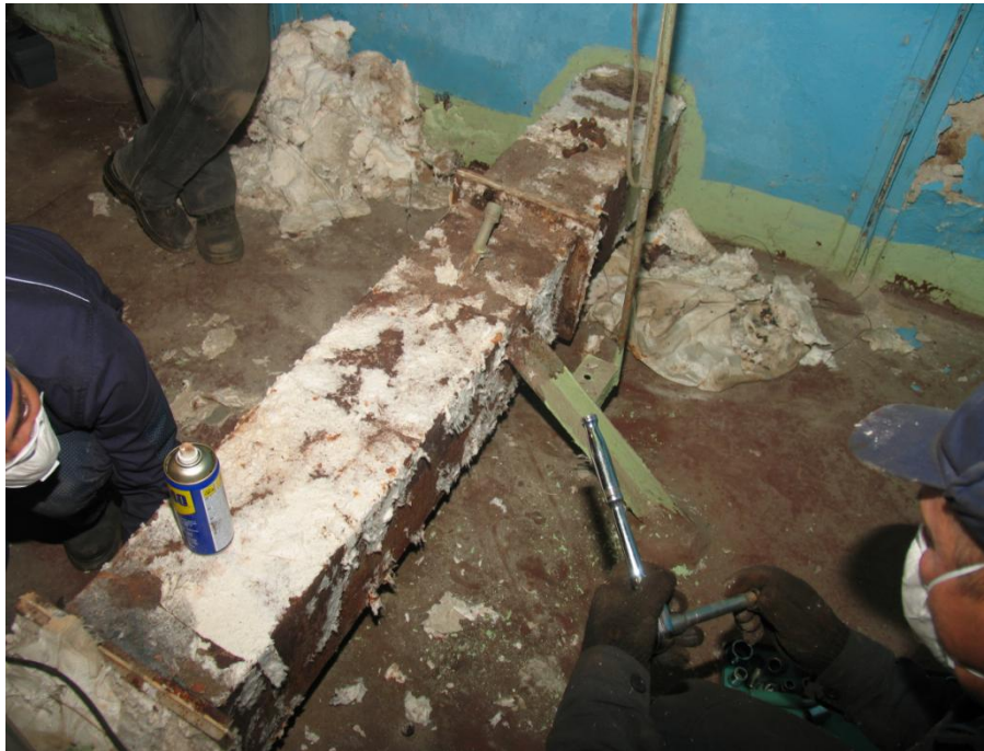
Фото 1 – Воздуховод всасывающий, существующий
